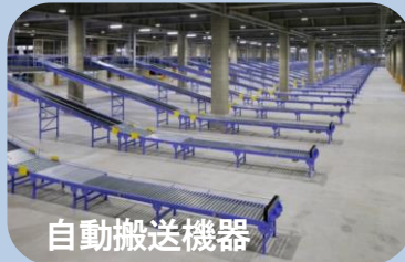
関東配送センター
